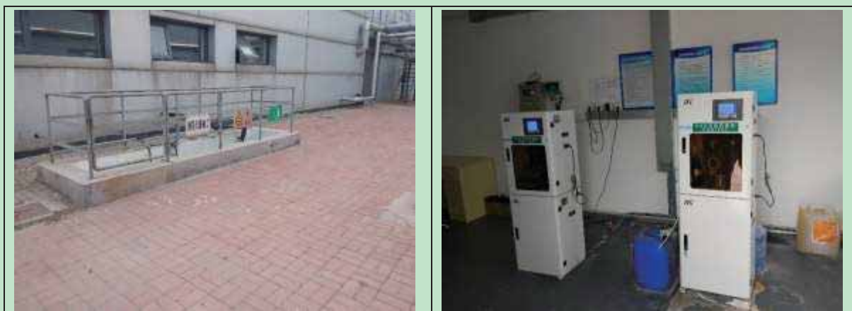
图 2.4-2 中药产业园总排口
